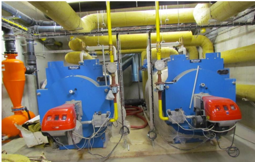
Chaudières gaz de secours
