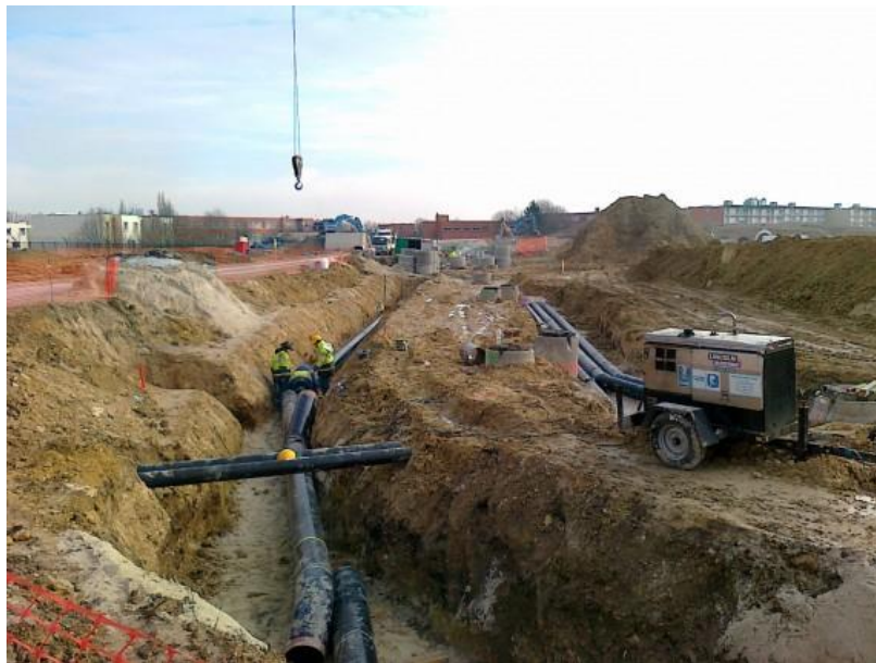
Croisement des réseaux de chaleur et d'aspiration des déchets
