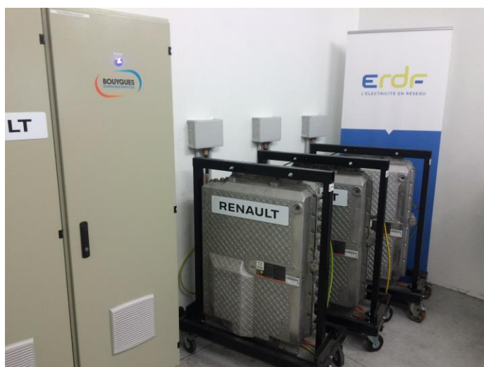
Les batteries de véhicules électriques utilisées dans le poste de distribution Bara - ©DR
